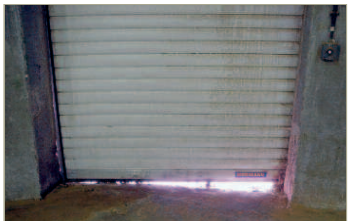
Abb. 5: Außentore müssen gem. IFS 4.9.6.2 so konstruiert sein, dass das Eindringen von Schädlingen verhindert wird, was hier nicht IFS konform umgesetzt wurde.
